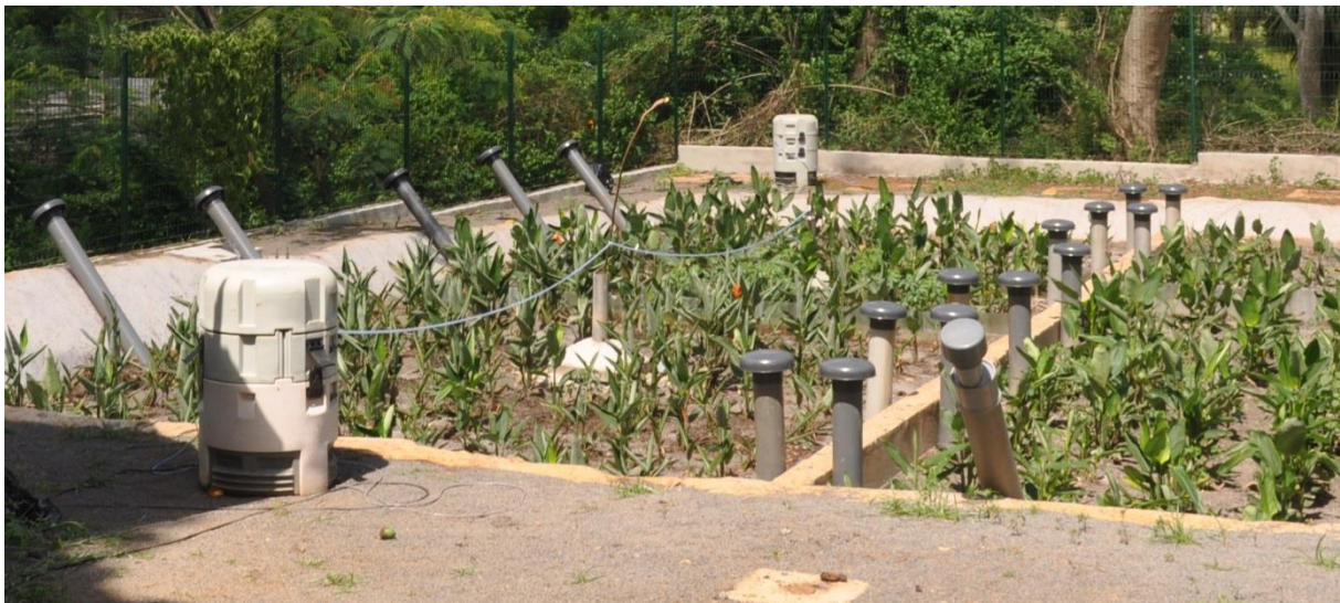
Figure 3 : préleveurs installés lors de la campagne. Au premier plan, prélèvement des eaux usées brutes sur les points d'alimentation. A l'arrière-plan prélèvement des eaux traitées.
