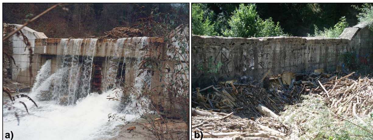
Figure 36 : Plage de dépôt : a) vue d'aval du barrage terminal durant la crue de décembre 1991 (© RTM 38) b) vue d'amont du barrage avant le curage du 20/08/2013 (© RTM 38)
