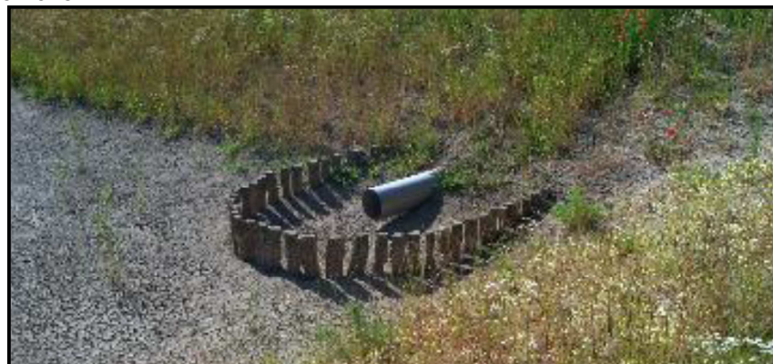
Figure 39 : Ouvrage de sortie de la ZTHA de Montepot (bassin versant de Rampillon)
