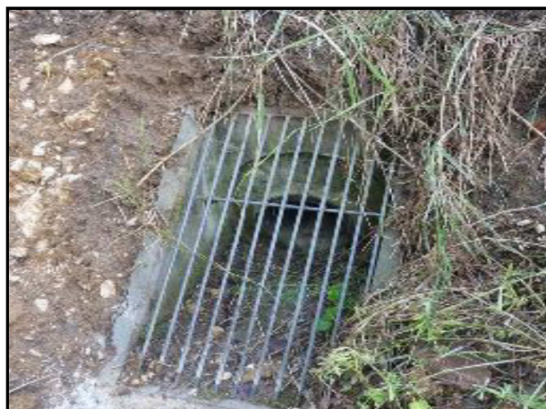
Figure 2 : Exutoire d'un collecteur de drainage
