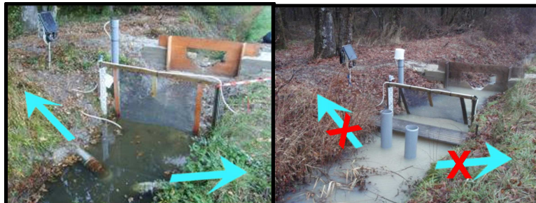
Figure 36 : Prises d'eau rustiques connectées à la ZTHA (site expérimental de Bray, Indre et Loire)
