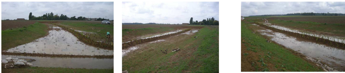
Figure 48 : Travaux de végétalisation de la ZTHA des Vaux (bassin versant de Rampillon)
