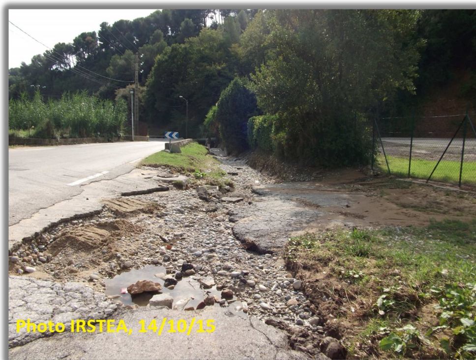
Figure 12 : Dommages en bord de chaussée, à l'amont du Vallon des Vaux (Cagnes-sur-Mer), photo prise lors de la visite terrain du 14/10/15
