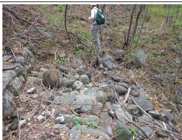
Photo 44 : Gabions éventrés – épi 1
