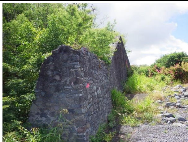
Photo 54 : Vue des dégradations de la crête du mur (épi 1)
