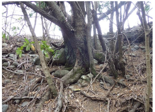
Photo 42 : Gros Faux-Poivrier en amont de l'épi 3 assurant la stabilité du talus, comme en témoignent les blocs retenus en amont de la souche et un glissement en aval s'arrêtant à la souche. Cet arbre n'a pas été dessouché par crainte de voir l'ensemble du talus s'écrouler, la pelle mécanique n'ayant pas d'accès pour se positionner en crête de la digue afin d'effectuer la reconstitution.
