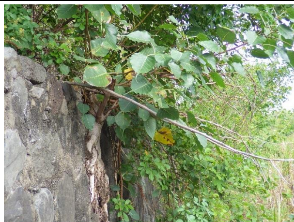
Photo 52 : Ficus dans une fissure du mur et végétation dense poussant sur le haut du mur
