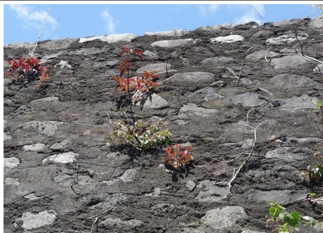
Photo 49 : Pousses ligneuses vivantes et mortes implantées dans les joints du mur maçonné
