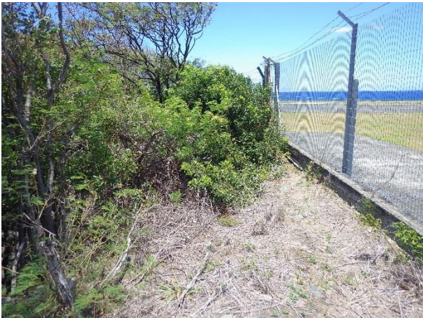
Photo 39 : Zone de glissement du talus côté rivière de la digue, en amont entre l'épi 4 et l'épi 5
