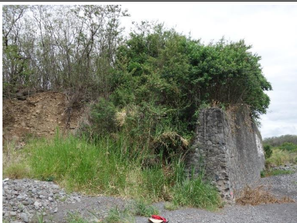
Photo 37 : Anse d'érosion marquée derrière le mur en aval de l'épi 3
