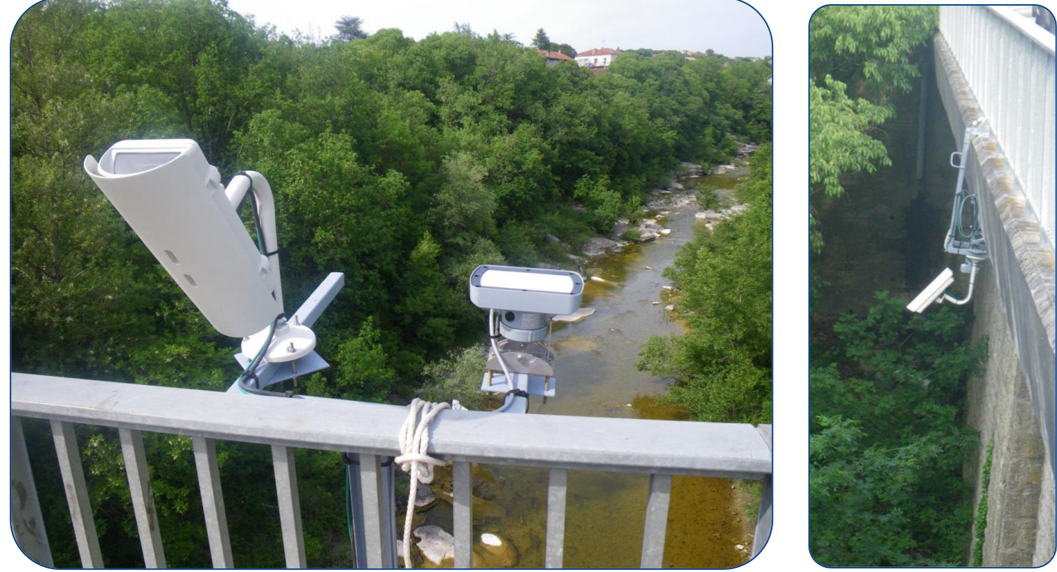
Station de l'Auzon – Montage des capteurs sur potence articulée
