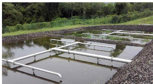
Figure 13. Mise en charge des filtres de la station de Taupinière au cours de la tempête Matthew. Ce sont les filtres de la 2 e ligne de la station qui ne sont pas encore en service et donc ne sont pas plantés, faute de charge suffisante.
