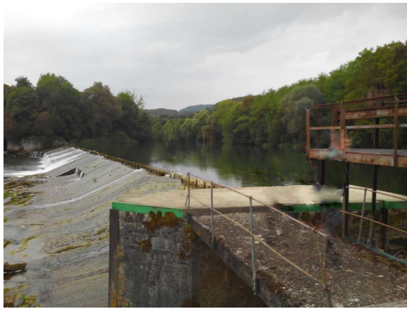
(a) Seuil de dérivation
