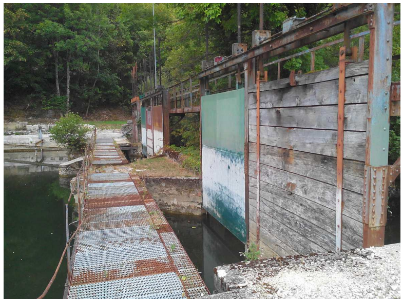
(b) Vannes du canal d'amenée de l'usine hydroélectrique de Bourguignon (25) (Crédit : David Dorchies, Irstea)
