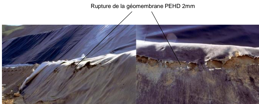
Figure 1. Rupture par traction sur talus d'une géomembrane PEHD 2 mm observée sur une ISD en Asie du sud, après excavation des déchets (Fowmes, 2007)
