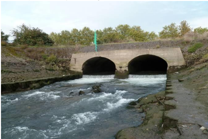
Figure 44. Confluence du Cailly dans la darse Barillon. Le radier de la buse est à 0,97 m NGF (5,35 m CMH) et le sommet de la buse à 3,57 m NGF (8,35 m CMH).
