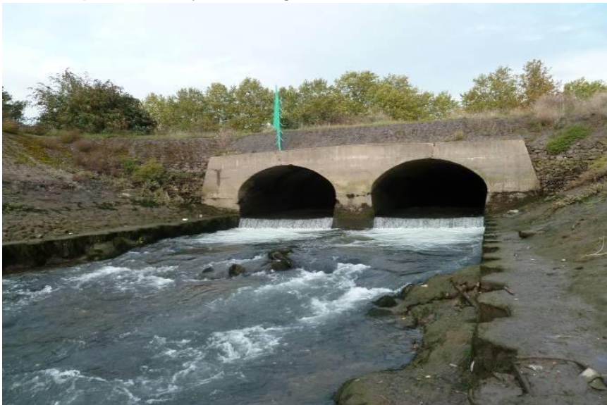
Figure 44. Confluence du Cailly dans la darse Barillon. Le radier de la buse est à 0,97 m NGF (5,35 m CMH) et le sommet de la buse à 3,57 m NGF (8,35 m CMH).
