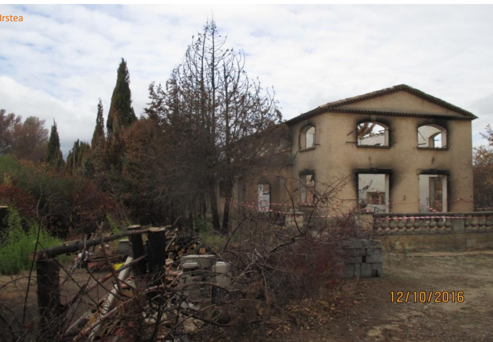
Château des Barnouins (Les Pennes-Mirabeau) 2 mois après le feu
