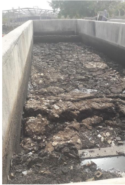
Figure 11 Bassin de sédimentation de la station de Rufisque-Nord
