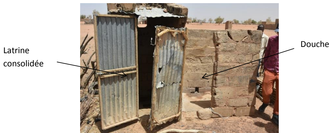
Figure 62 Latrine simple consolidée et douche d'un foyer modeste de Ranérou
