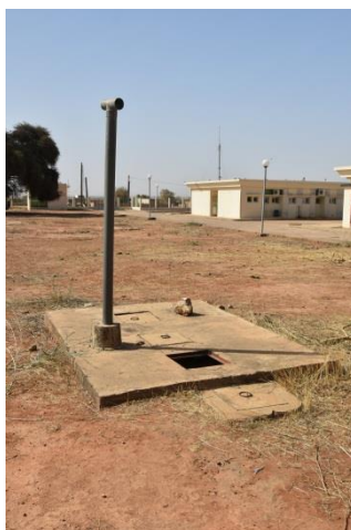
Figure 48 Fosse d'aisance pour les toilettes visiteur du poste de santé de Ranérou
