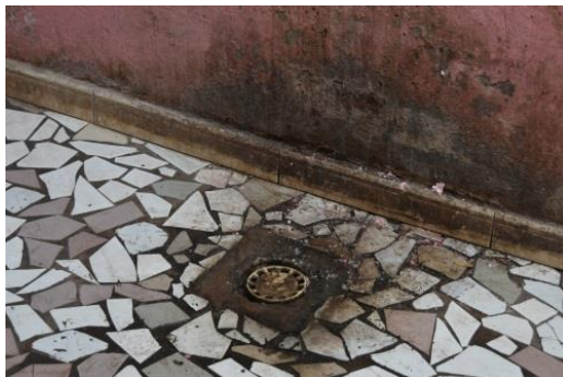
Figure 41 Evacuation vers la fosse perdue des eaux grises (foyer de classe moyenne, Santa Yalla)
