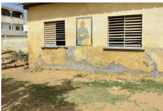
Figure 24 Infiltration des eaux dans les murs d'une classe du collège de Santa Yalla
