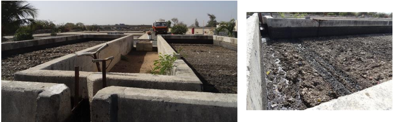
Figure 14 Bassin de sédimentation des boues de vidange de la station de Pikine
