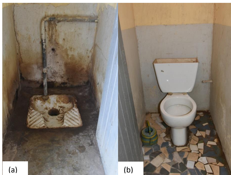
Figure 26 (a) Toilette des élèves, (b) toilettes des professeurs du collège de Rufisque, Santa Yalla
