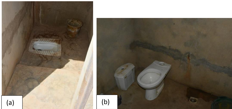
Figure 53 (a) Toilette des filles, (b) Toilette des professeurs du Lycée de Ranérou
