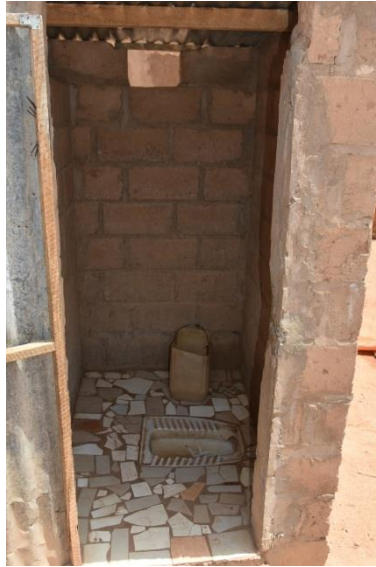
Figure 66 Toilette d'un foyer de classe moyenne à Ranérou
