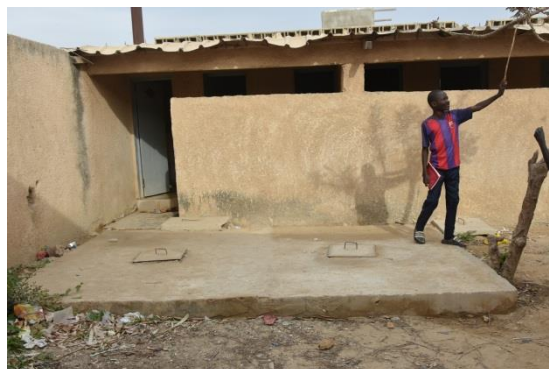
Figure 31 Fosse "septique" de l'école primaire Shérif 3, Tacco
