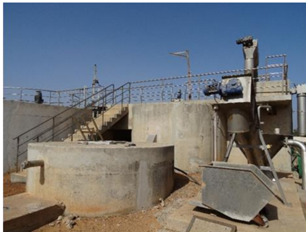
Figure 21 Station de traitement des eaux usées de la ville de Pikine
