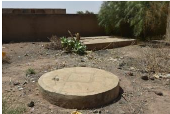
Figure 59 Fosse circulaire pour les eaux noires du collège de Ranérou
