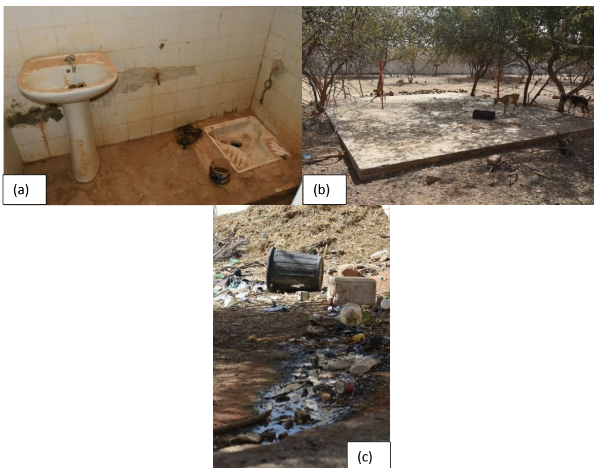
Figure 49 (a) Salle de toilette d'une chambre du poste de santé, (b) fosse de récupération des eaux grises et noires du poste de santé, (c) sortie de la fosse septique du poste de santé de Ranérou
