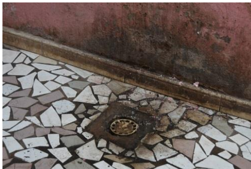
Figure 41 Evacuation vers la fosse perdu des eaux grises (foyer de classe moyenne, Santa Yalla)
