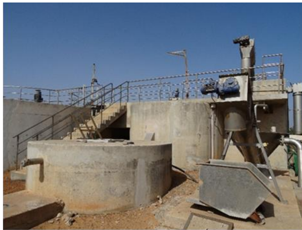
Figure 21 Station de traitement des eaux usées de la ville de Pikine
