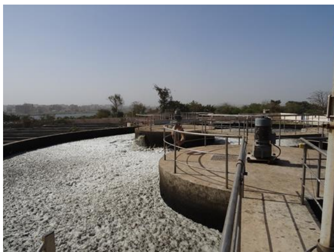
Figure 22 Bassin boue active aéré pour le traitement des eaux usées de Pikine
