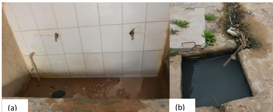
Figure 29 (a) Point d'eau courante de l'école, (b) fosse d'évacuation des eaux grises du lavabo des toilettes, Tacco
