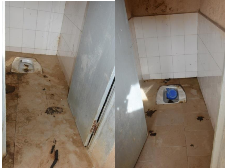
Figure 30 Etat des toilettes de l'école Shérif 3, Tacco
