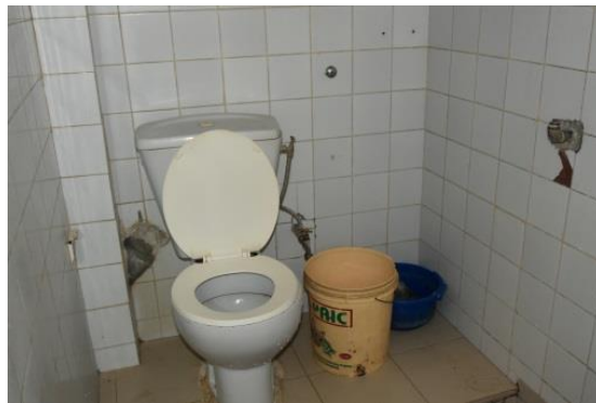
Figure 39 Toilette à chasse d'eau avec assise, foyer classe moyenne, Santa Yalla
