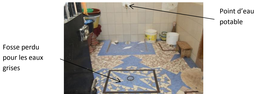
Figure 43 Cour intérieure du foyer avec un point d'eau et le regard de la fosse perdue accueillant les eaux grises
