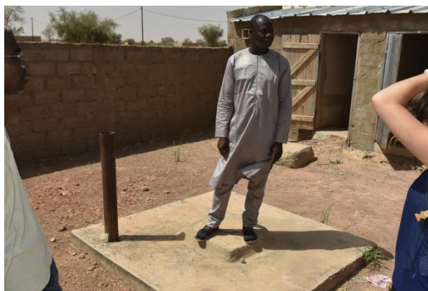
Figure 54 Fosse pour les eaux noires du lycée de Ranérou
