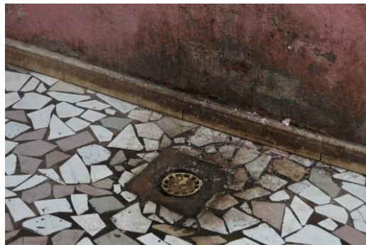
Figure 41 Evacuation vers la fosse perdue des eaux grises (foyer de classe moyenne, Santa Yalla)
