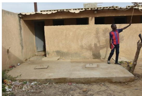
Figure 31 Fosse "septique" de l'école primaire Shérif 3, Tacco
