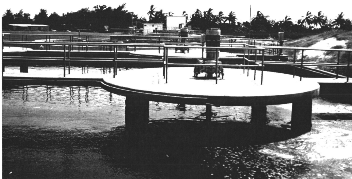
Photo N o 10 : Les bassins d'aération
