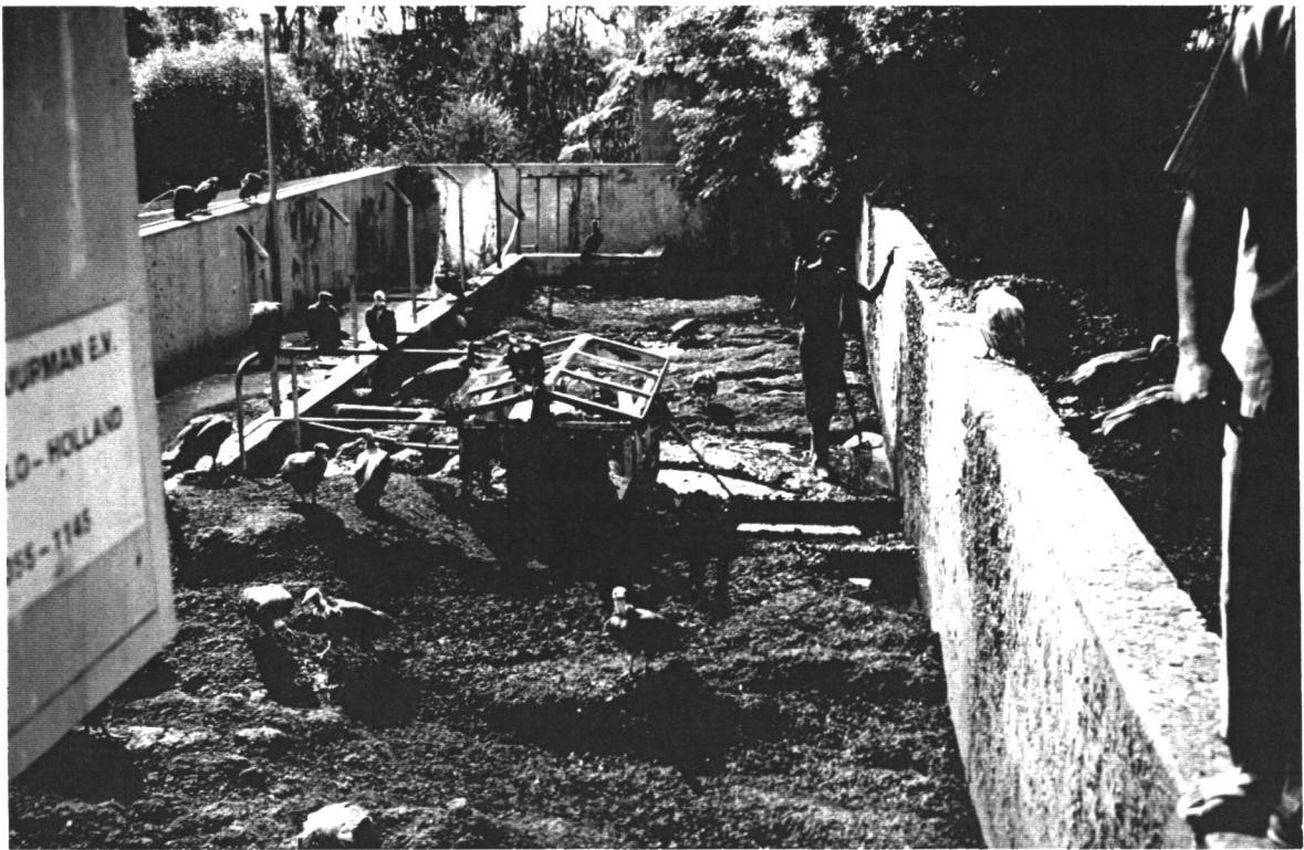
Photo N° 4 : Station d'épuration de l'abattoir.
