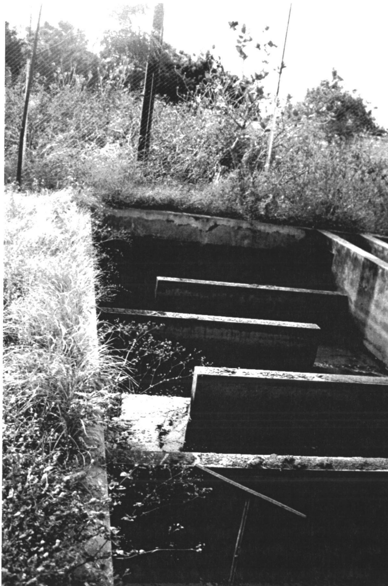
Photo N° 6 : Un des bassins recueillant les eaux usées de la brasserie SOBEBRA.
