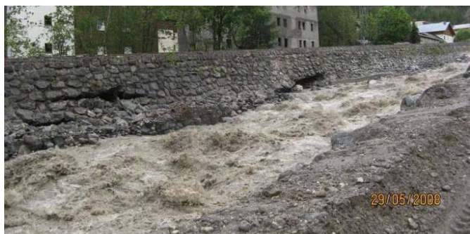
FIGURE 4 : AFFOUILLEMENT DU PIED DE DIGUE - LA VALLOIRETTE - VALLOIRE (73) - MAI 2008 (ONF-RTM)
