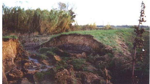
PHOTO 2 : EXEMPLE DE DEPART DE BRECHE (© BRLI)
