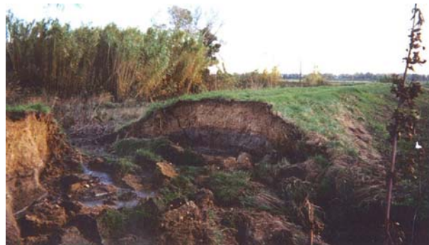
PHOTO 2 : EXEMPLE DE DEPART DE BRECHE (© BRLI)
