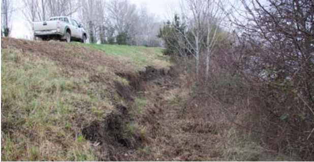
PHOTO 3 : EXEMPLE DE DESORDRE (© SYMADREM)
