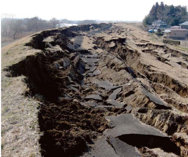
FIGURE 4 : RUPTURE DE DIGUE DE LA RIVIERE NARUSE PAR LIQUEFACTION SUITE A UN SEISME (2011) AU JAPON (PHOTO MLIT, MINISTRY OF LAND, INFRASTRUCTURE, TRANSPORT AND TOURISM, JAPAN)
