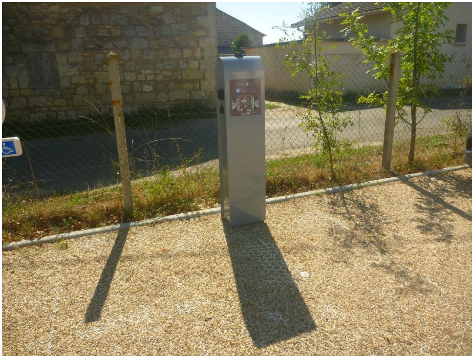
Figure 9 : Borne de recharge pour les véhicules électriques (© P Chèvre, Irstea)
