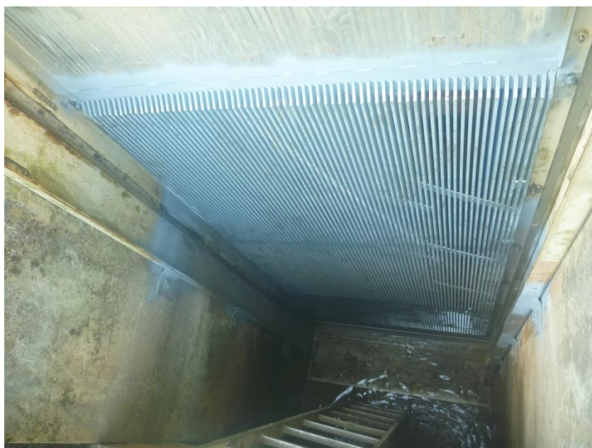
Figure 5 : Le dégrilleur en place (© P Chèvre, Irstea)
