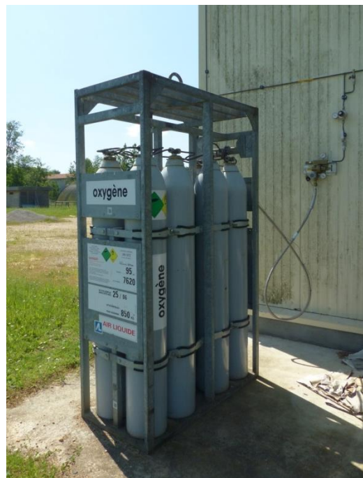
Figure 1 : Réserve d'oxygène pur à l'extérieur du bâtiment Sturio 2 (© Ph Jatteau, Irstea)
