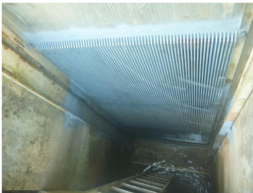
Figure 5 : Le dégrilleur en place (© P Chèvre, Irstea)
