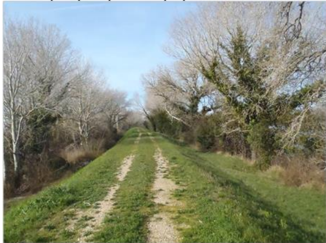
FIGURE 7 : PHOTO DE LA DIGUE RIVE DROITE DU PETIT RHONE DANS LE SECTEUR DU MAS MARIGNAN, BORDE DE VEGETATION ARBORESCENTE A CHAQUE PIED DE L'OUVRAGE (PHOTO : BAMBARA G., 2015)
