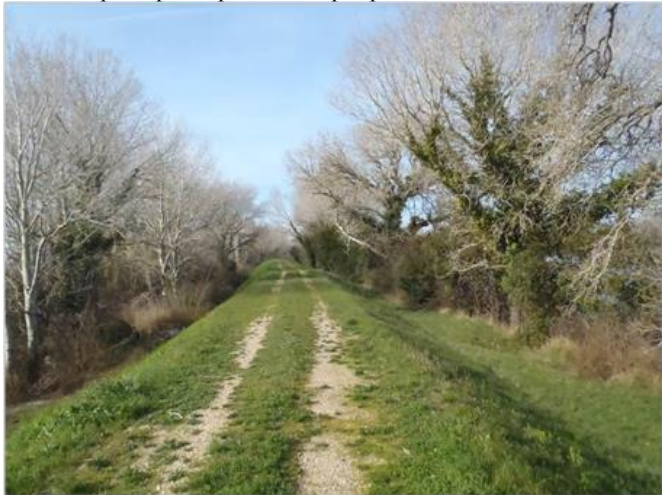
FIGURE 7 : PHOTO DE LA DIGUE RIVE DROITE DU PETIT RHONE DANS LE SECTEUR DU MAS MARIGNAN, BORDE DE VEGETATION ARBORESCENTE A CHAQUE PIED DE L'OUVRAGE (PHOTO : BAMBARA G., 2015)
