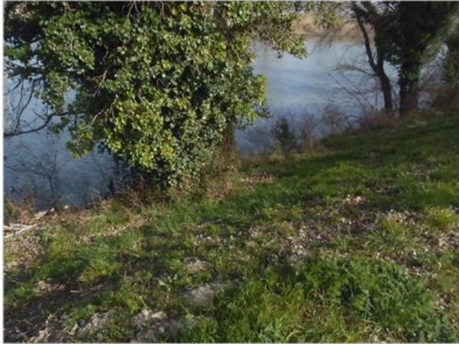
FIGURE 9 : GROS PEUPLIER PRESENT SUR LE TRONÇON HOMOGENE EVALUE VIS-A-VIS DU MECANISME DE DETERIORATION PAR EROSION INTERNE DE LA DIGUE RIVE DROITE DU PETIT RHONE, SECTEUR MAS MARIIGNAN (PHOTO : BAMBARA G., 2015)
