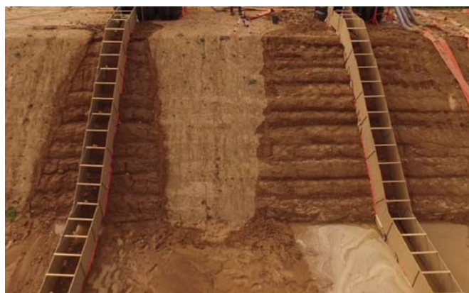
FIGURE 10: VUE DU SOL APRES LA CAMPAGNE D'ESSAIS. LES FUITES ONT PROVOQUEES UNE EROSION DU SOL DE PART ET D'AUTRE DES CANAUX.
