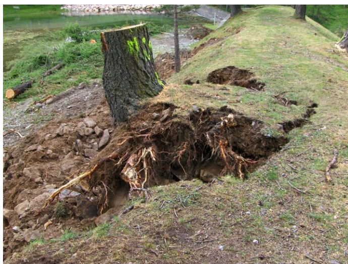
Photo 4: Arrachement imprévu d'une partie du remblai lors de l'étude des systèmes racinaires de la digue de Castérino en 2009. La rupture du remblai jusqu'au-delà du milieu de la crête donne une idée de la masse que pourrait emporter un arbre couché par une tempête. Photo C. Zanetti
