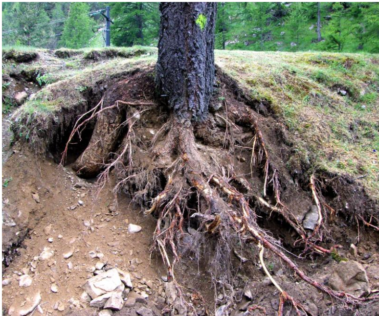
Photo 7 : Sur la gauche de ce système racinaire, une énorme racine plonge dans cœur de la digue.
