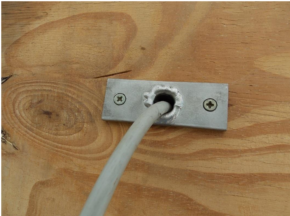
Figure 4. Passage du câble électrique souple au travers de l'axe central de rotation des lampes. (Photo : Frédéric Pascal, INRA PACA).
