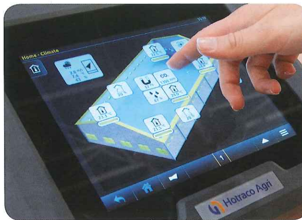
Les bâtiments avicoles sont équipés d'appareils de contrôle, de capteurs et d'un ordinateur qui aident l'éleveur à maîtriser les conditions climatiques (l'ambiance) dans l'élevage. Photo : Source Vencotec.
