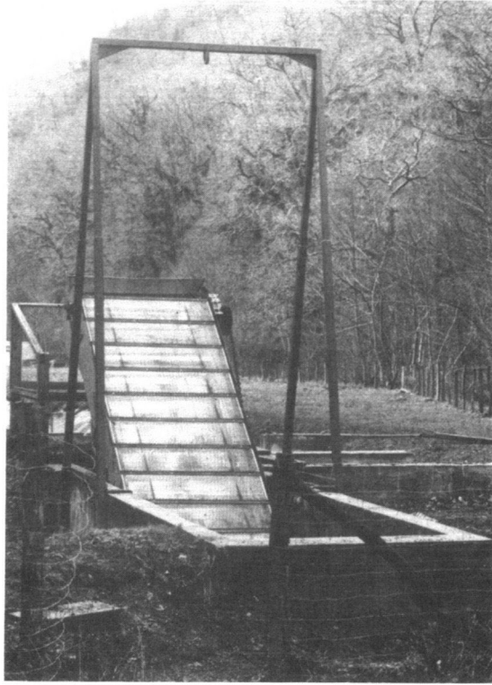
Figure 6 : Grille de défeuillage
