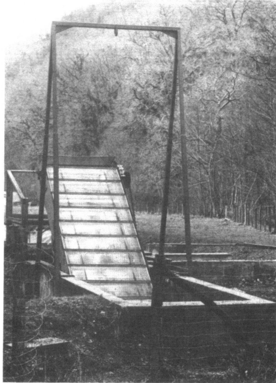
Figure 6 : Grille de défeuillage
