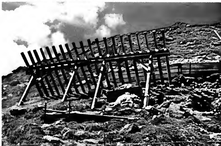
Photo n° 6 : Ouvrage paravalanche provisoire en bois ; les pieds sont protégés par un enrobement de pâte anti- septique à l'intérieur d'un embal- lage de plastique Photo PONCET
