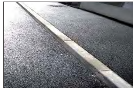
Photo n°9 : Un caniveau sans plaque de fond pour limiter la rupture de revêtement
