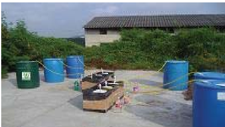
Foto 2 Instalación del Sistema, para la Producción de Biogás a partir de la cáscara y rastrojos de Arroz tratada con Urea y con Orina de Conejos.
