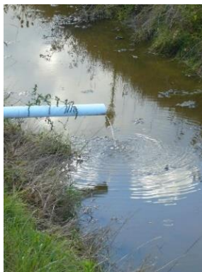
Figure 9 : Tuyau évacuant l'eau issue des drains dans un fossé
