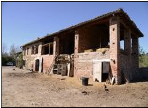
Figure 10 : La ferme pédagogique de Salsas, un bâti à rénover pour la préservation d'une activité maraîchère
