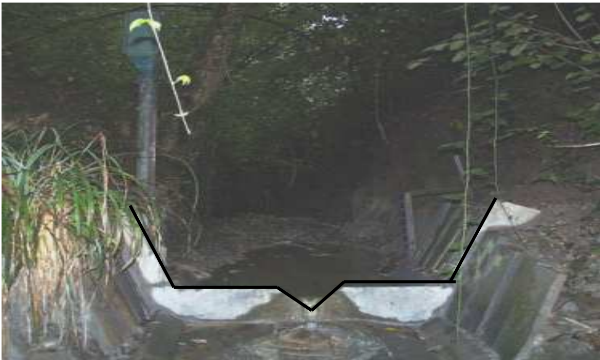
Figure 17 : Capteur limnimétrique du Mercube avant la crue de novembre 2002. Section en double V.
