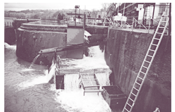
Installation de piégeage et de contrôle d'avalaison pour juvéniles de saumons et géniteurs d'anguilles à l'usine d'Halsou sur la Nive, 2001.
