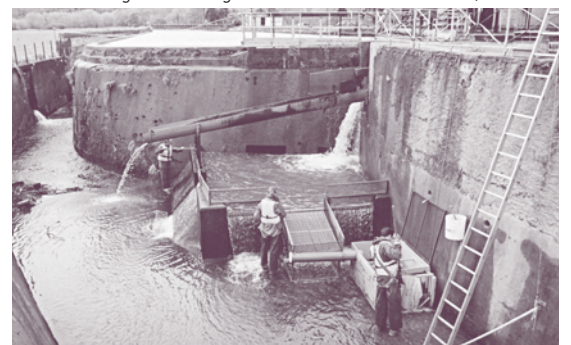
Contrôle du piégeage de juvéniles de saumons à l'usine d'Halsou sur la Nive, 1998.
