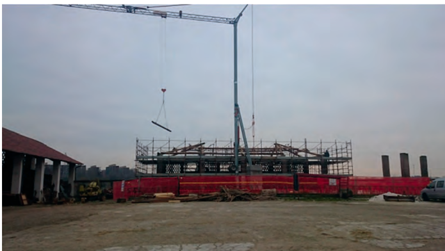
Photos 7 et 8. Municipalité de Milan, travaux d'entretien exceptionnels à faire et en cours. En haut, nécessité de renforcement, nettoyage et protection de la façade; en bas, travaux de substitution du toit (cl. E. Colli)
