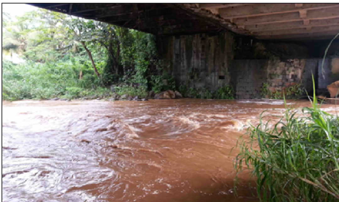
Figure 6 - Crue observée à la station PONT de la rivière Pérou
