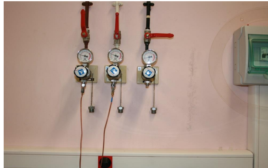
Fermeture des vannes en amont de l'analyseur
