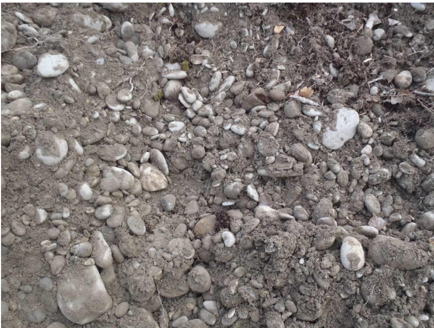
Figure 3: matériau constitutif du corps de digue et du talus de piste où sont enfouies les racines.
