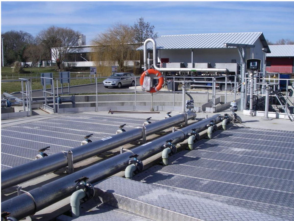
Figure 1 : Vue de la station : bassins concentriques groupant zone anoxie, bassin d'aération et membranes
