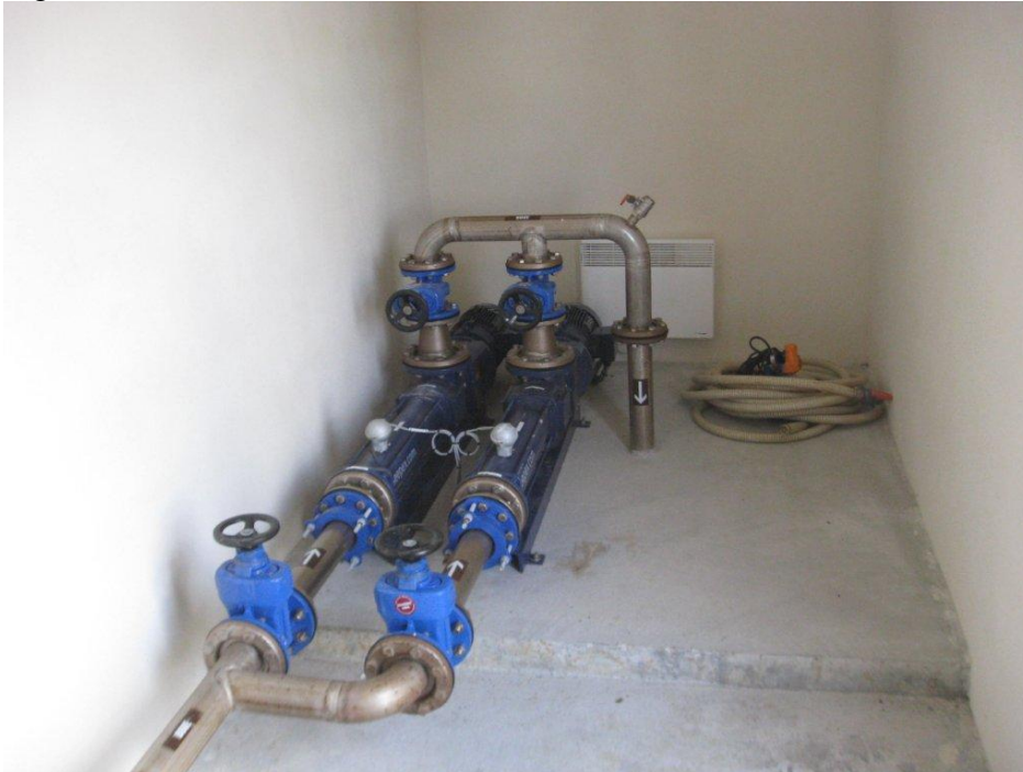
Figure 11 : Pompes d'extraction des boues
