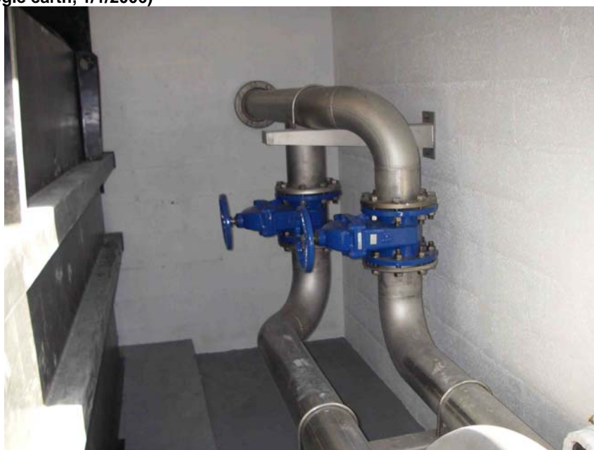
photo 2 : Vannes manuelles de bypass de la station
