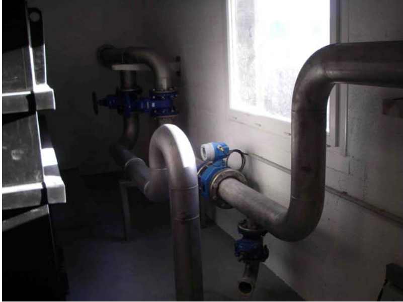
photo 3 : Débitmètre en entrée de station
