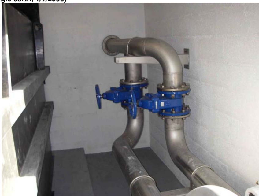
photo 2 : Vannes manuelles de bypass de la station
