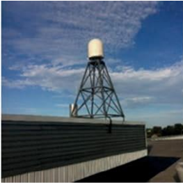
Chappes La Varenne Centre de recherche de Limagrain Hauteur d'émission : 15 mètres Portée : 72 km
