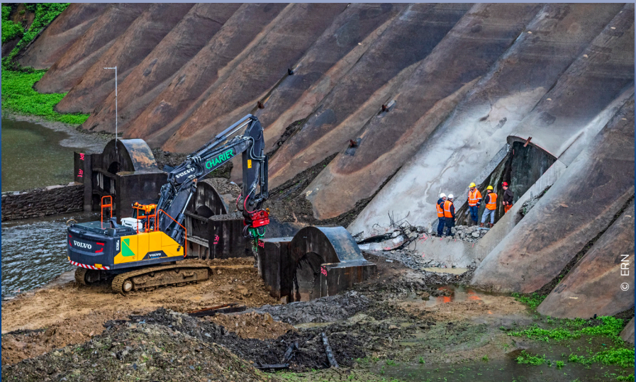
Figure 10. Première brèche de 5 mètres dans le barrage de Vezins en juin 2019.
