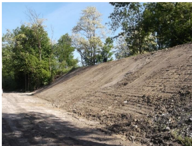
Figure 9.9 : Remise en état du site. Chantier Digue Isère aval à Noyarey (38) (Crédit Photo : SYMBHI)
