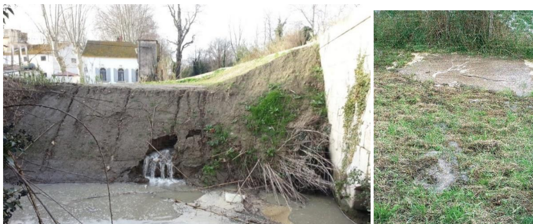
Figure D.1 : Fuites importantes d'eau légèrement boueuse (à gauche) et boueuse (à droite) (© SYMADREM à gauche et PNRC à droite)
