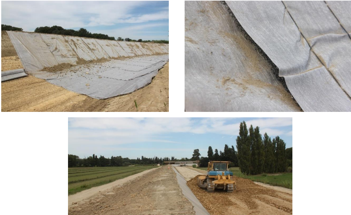
Figure 4.15 : Photographies d'un chantier de drainage en pied par utilisation d'un géo-drainant/filtrant (Crédit Photo : Symadrem)
