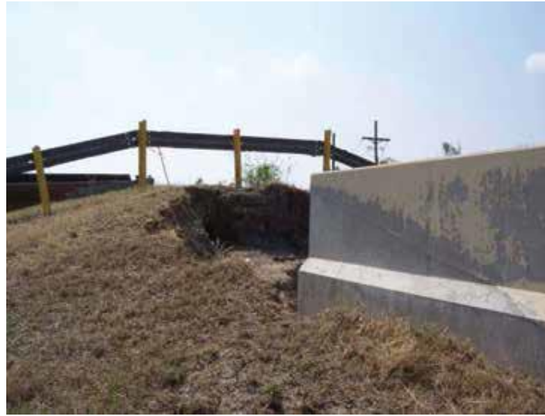
Figure 8.9 : Photographie d'une brèche à la transition entre deux tronçons d'une digue : l'un en remblai et l'autre en béton armé [8-4]
