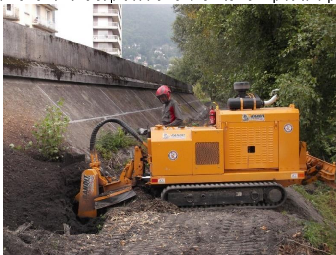
Figure 9.3 : Photographie d'un abattage définitif avec rognage du tronc au droit du terrain naturel (Crédit photo : ADIDR – 2014 – Grenoble Isère RG (38))
