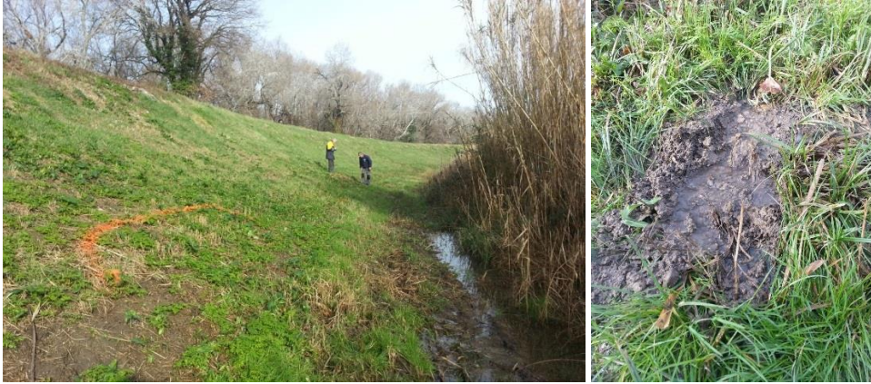
Figure D.4 : Infiltrations d'eaux claires (Crédit photo : SYMADREM)
