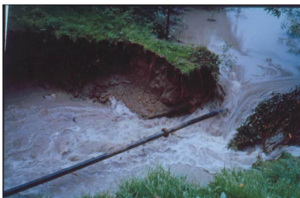
Figure 8.6 : Brèche dans une digue, au droit d'une conduite traversante sur le Rhône (Crédit photo : SNRS)
